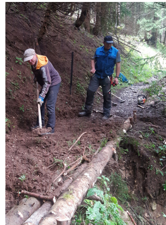
Sanierung des Hangrutsches am Bodenalmsteig mit der Gemeinde Rottach-Egern // ALE MÜLLER
